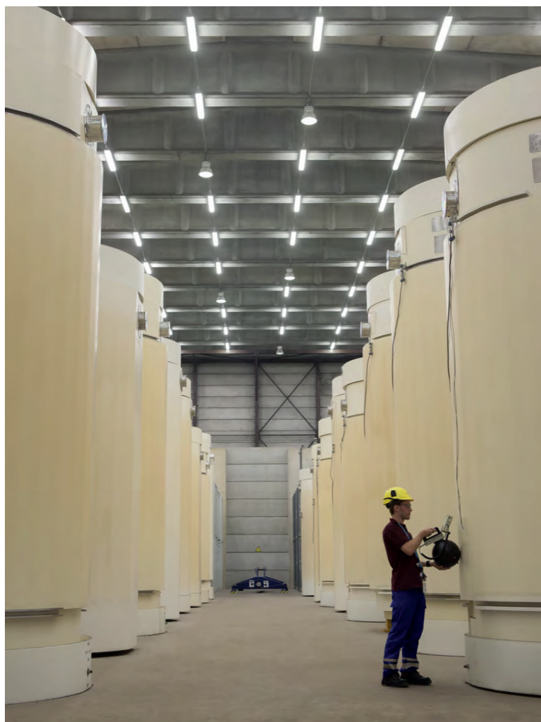
Centrale nucléaire de Doel. Bâtiment centralisé abritant les conteneurs d'entreposage à sec du combustible usé. Photothèque ELECTRABEL.
