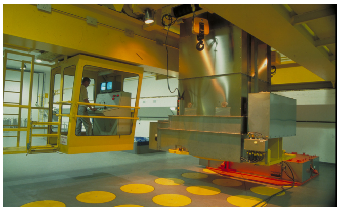
Site van Belgoprocess in Dessel - Opslaggebouw voor opwerkingsafval
